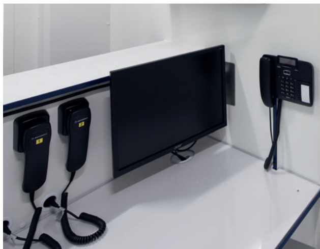
Das Fahrzeug ist mit Funkgeräten, WLAN-Router und Monitoren ausgestattet.
